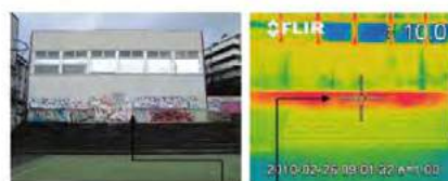
Fuite à la base du bâtiment: pont thermique
